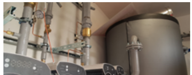
Chaufferie bois de L'Espace Dirac
